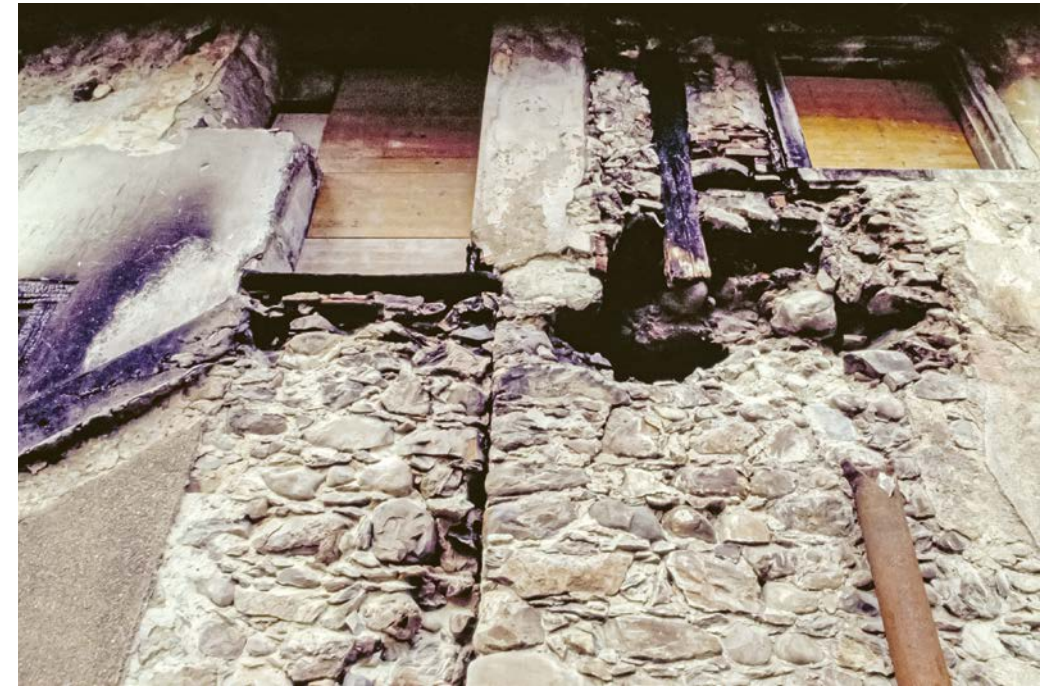
01 Senkrechte Baunaht zwischen dem 1. und 2. Obergeschoss an der Südfassade. Foto: Kantonsarchäologie Aargau, Th. Frey.
