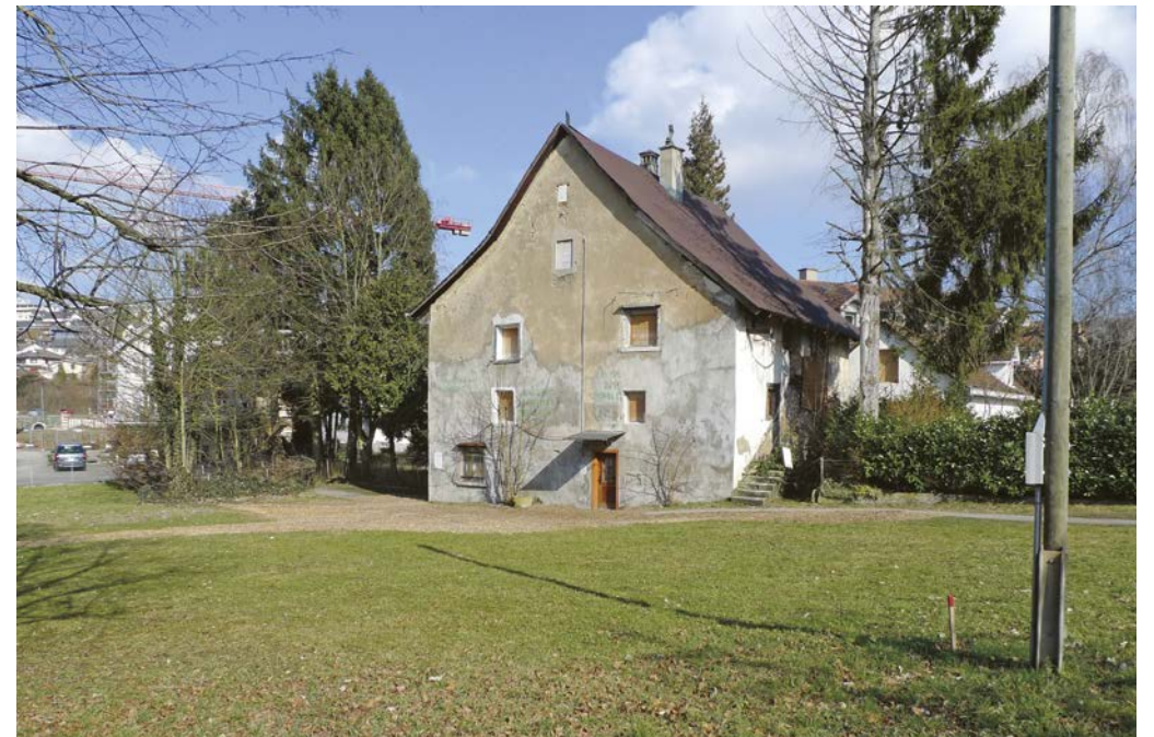
Das ruinöse Schlössli nach drei Bränden mit Notdach 2014. Foto: Fabian Furter.
